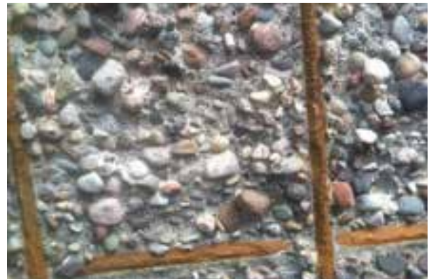
Deterioro por Corrosión Microbiana Inducida (MIC) en la estructura de captación de una planta de tratamiento de aguas residuales con una pérdida aproximada de 2 pulgadas de concreto.
