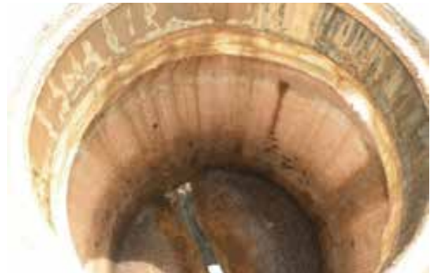
Los registros de Terrebonne Parish en los que se usó Admix con tecnología de cristalización muestran un deterioro mínimo después de 10 años de servicio.
