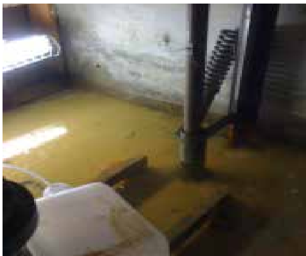
Filtración de agua en un foso de elevador.
