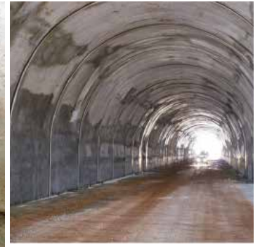
Filtración al interior de túneles
