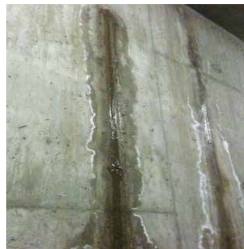
Filtración en juntas
