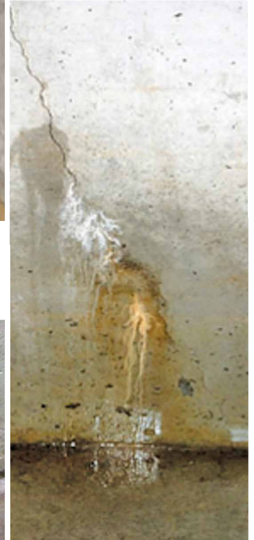
Filtraciones a través de grietas y juntas
