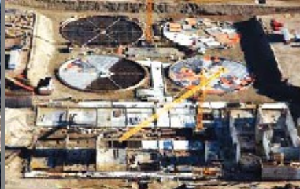
Pine Creek Szennyvízkezelő Telep, Kanada
