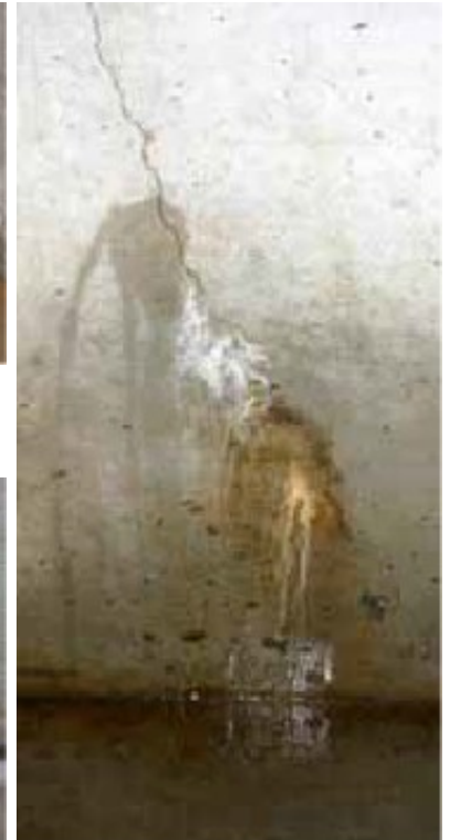
Vízbetörés és szivárgás a repedéseken
