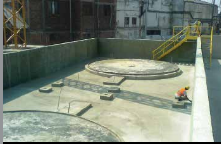
Merako WWTP, Slovakia
