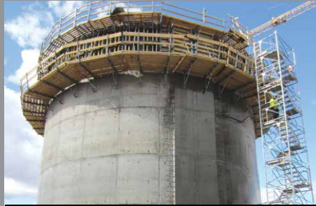
Tartu Biogas Plant, Estonia
