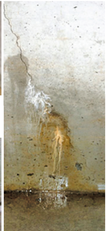
Prodor kroz pukotine / građevinske spojeve
