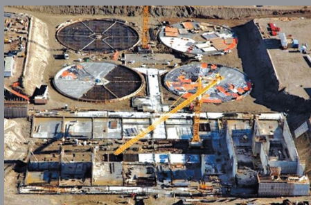
Postrojenje za preradu otpadnih voda Pine Creek, Kanada
