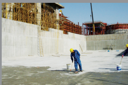
Skladište uglja u elektrani, Kina
