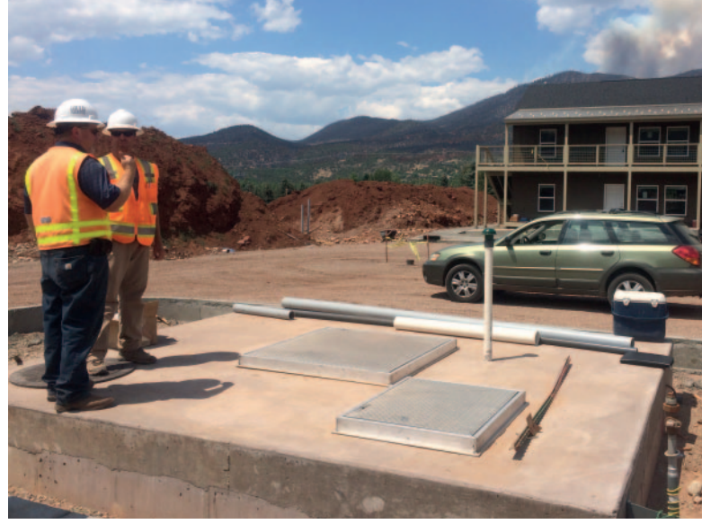
Şek. 6: Giriş kapılı yaklaşık 25 cm kalınlıkta bir kapak ise yerinde dökme betonla dökülüyor.
