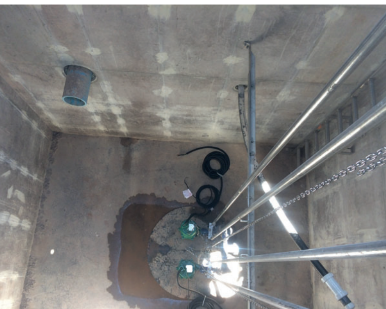
Abb. 7: Blick von oben in die neue Förderstation, ein Schlüsselement der Abwasser-Infrastruktur für die Erweiterung des exklusiven Fork Club in Basalt im US-Staat Colorado
